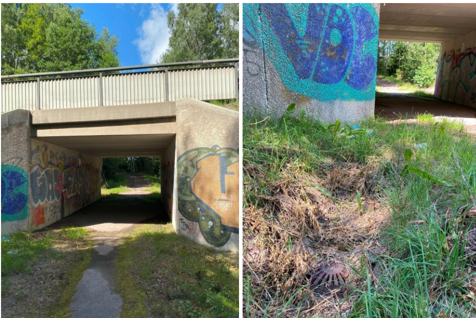
Figur 3-24. Södra vägporten (Vägport 3) som vid skyfall magasinerar en stor mängd vatten (höger) och en av dess fyra kupolsilsbrunnar (vänster) (Foto:Sweco).
